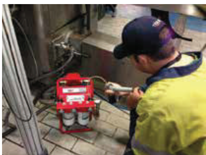
Sistema de Filtración Manual
