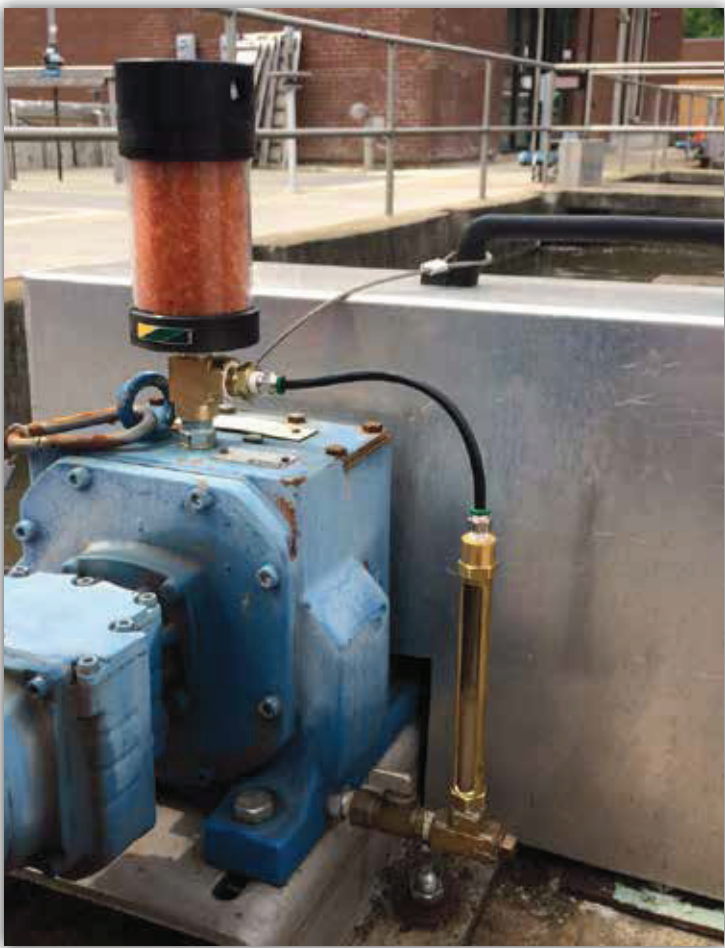
Indicadores de nivel líquido de sistema cerrado con línea de balanceo de presión conectada a una caja de cambios
